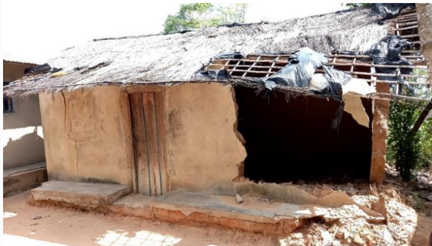
À esquerda, uma casa parcialmente destruída pelo ciclone
